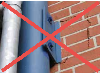
Následné škody způsobené chybným připojením ke zdi.
